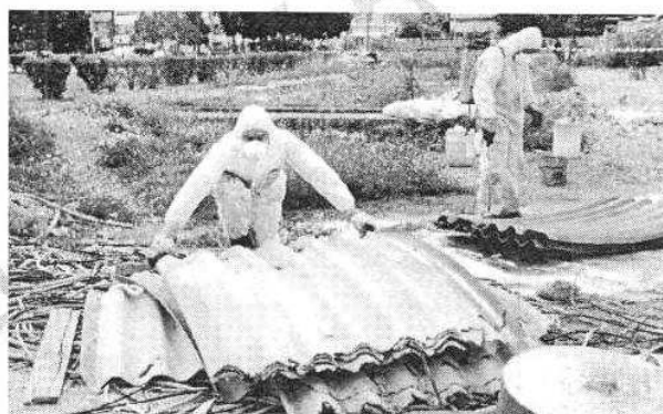
Le bonifiche dall'amianto procedono a rilento, tra mille intoppi e difficoltà
